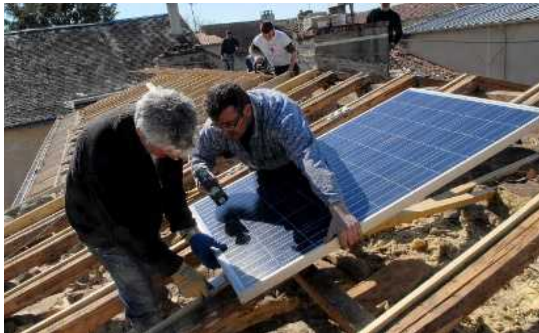
De nombreux logements de l'office départemental d'HLM devraient être équipés de chauffe-eau solaires. Économie prévisible : jusqu'à 200 € par an.
